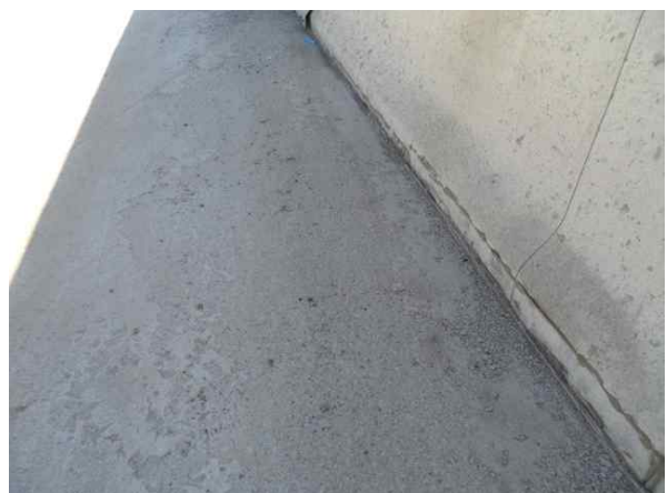
교면포장 S5 접속도로 포장박리(1.5×7.0)
