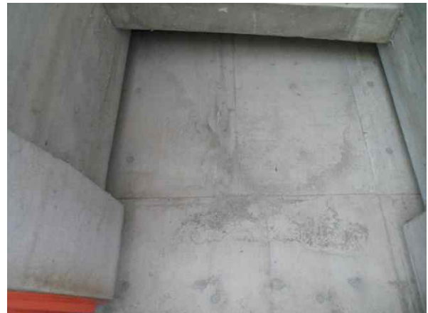
교대 A2 홍벽 균열(Cw=0.3mm미만)
