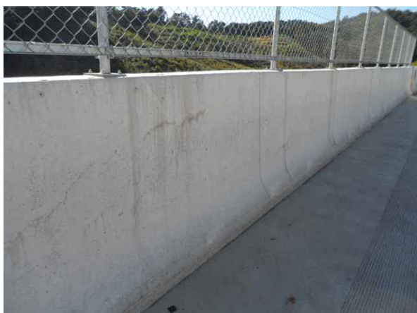
방호벽 S4 균열(Cw=0.3mm미만)
