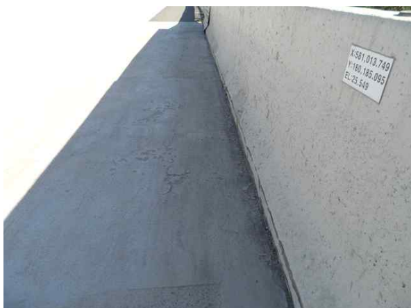
교면포장 S1 접속도로 포장박리(1.5×7.0)
