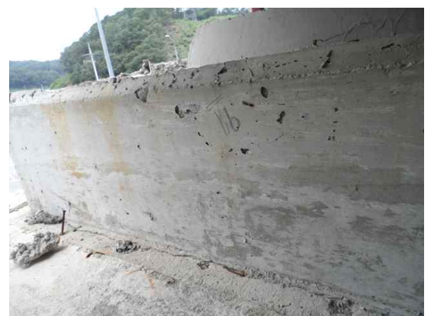
P3-Sh1 받침콘크리트 균열 ( C_w=0.3\text{mm} 미만)
