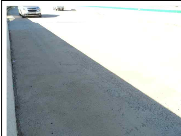
교면포장 S4 접속도로 포장박리(2.5×5.0)
