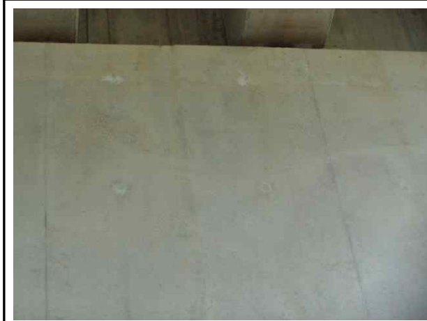
교각 P8 코핑부 균열( C_w=0.3\text{mm} 미만)
