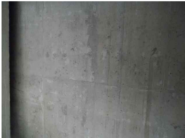
교대 A1 홍벽 균열(Cw=0.3mm미만)
