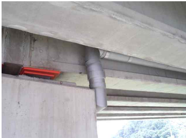
배수시설 S13 배수관 이음부 불량(1EA)
