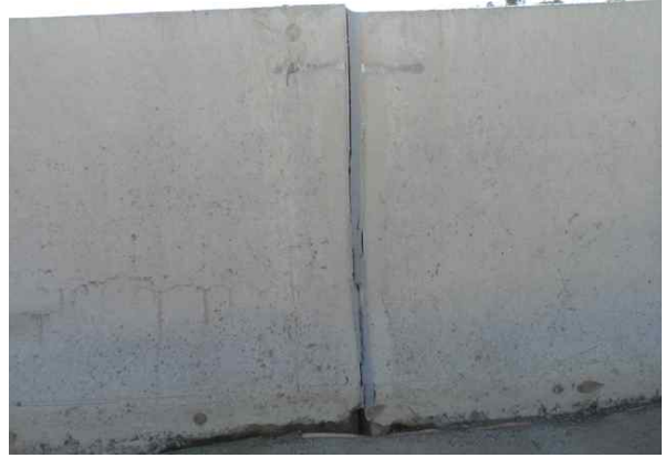
방호벽 S4 실란트파손(L=1.5m)
