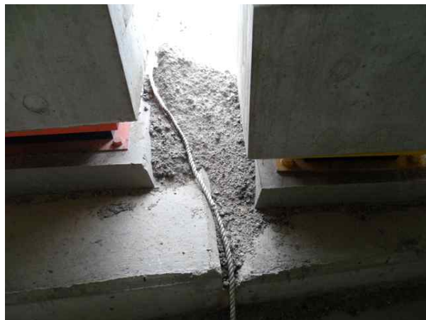
교각 P2 코핑부 폐콘크리트 퇴적( 1.0 \times 1.0 )
