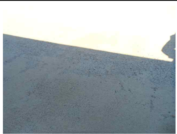
교면포장 S4 접속도로 포장박리(2.5×5.0)
